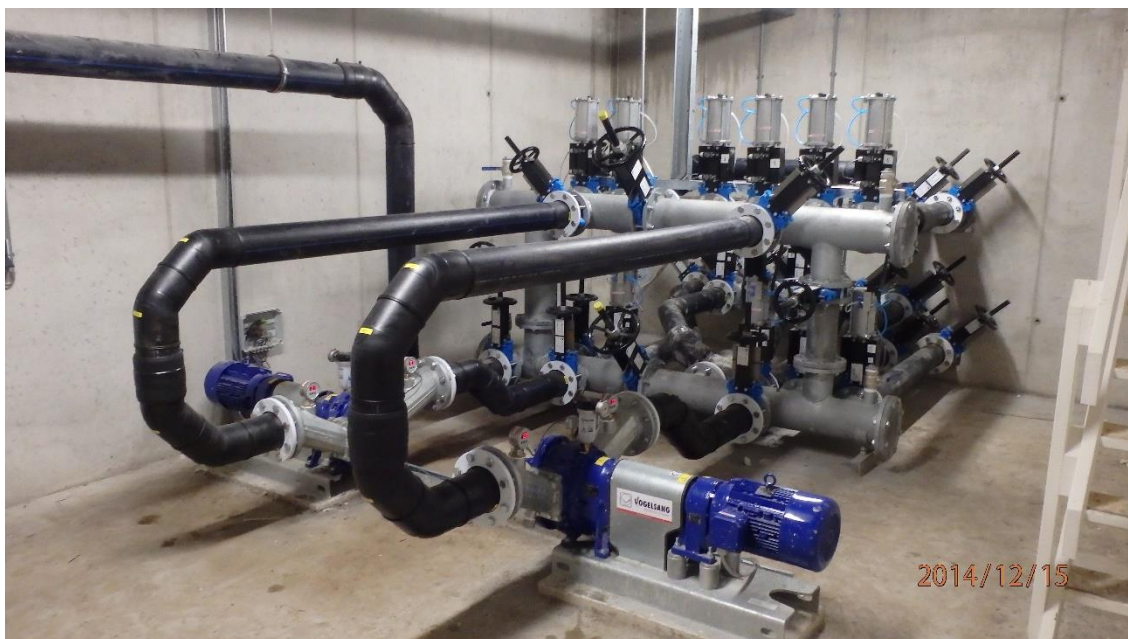
Ilustración 20. Colector de bombeo con dos bombas centrales
