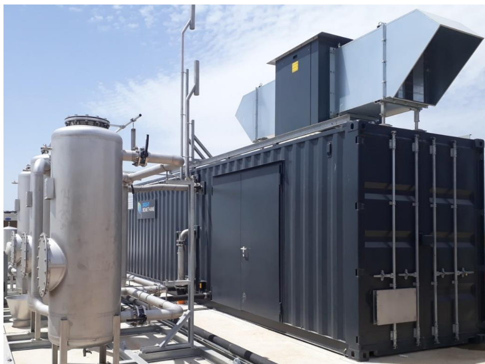
Ilustración 18. Unidad de Upgrading contenerizada
