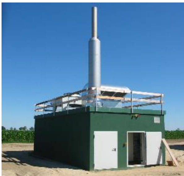
Ilustración 24. Chimenea de evacuación de los gases de escape
