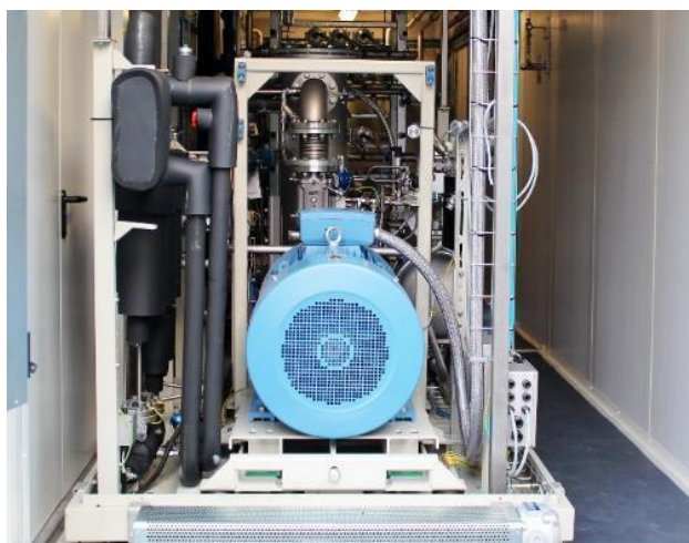
Ilustración 15. Compresor de biogás de una instalación de upgrading
