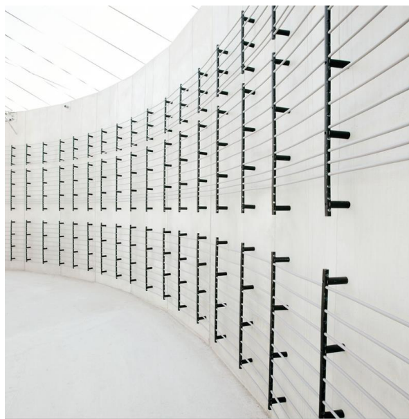
Ilustración 11. Calefacción interna con tubos de acero inoxidable
